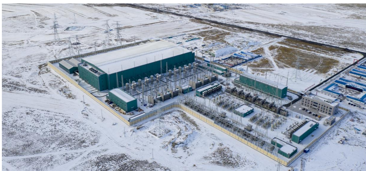
图8 张北柔性直流电网试验示范工程
